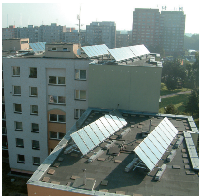
Obr. 1.1 Soustavy solární přípravy teplé vody na bytových domech v Orlové, foto archiv BD Orlová
